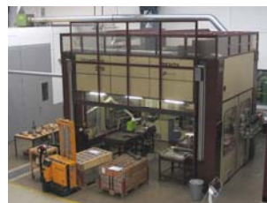
2 kW CO 2 -Laseranlage Portal-Roboter, 6 CNC-Achsen X-Y-Z 2.7 x 1.8 x 0.9 m A,B,C 360°,±90°,360° mit Konturerfassungssystem
